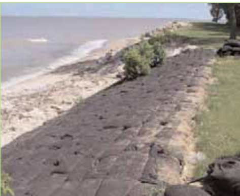
Shoreline Envirolok mattress wall
